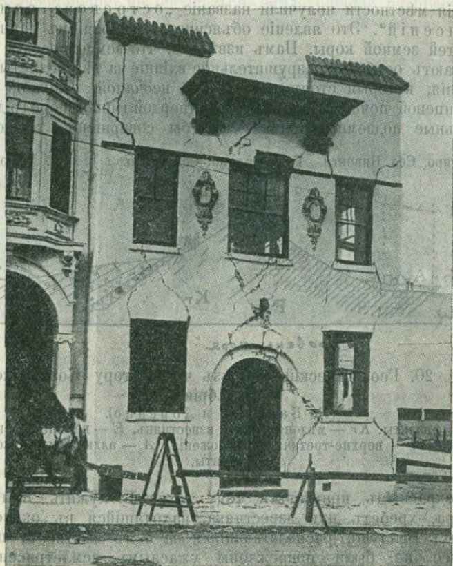
Рис. 19. Трещины въ видѣ буквы X въ стѣнѣ дома при землетрясеніи въ Санъ-Франциско (1906 г.).
