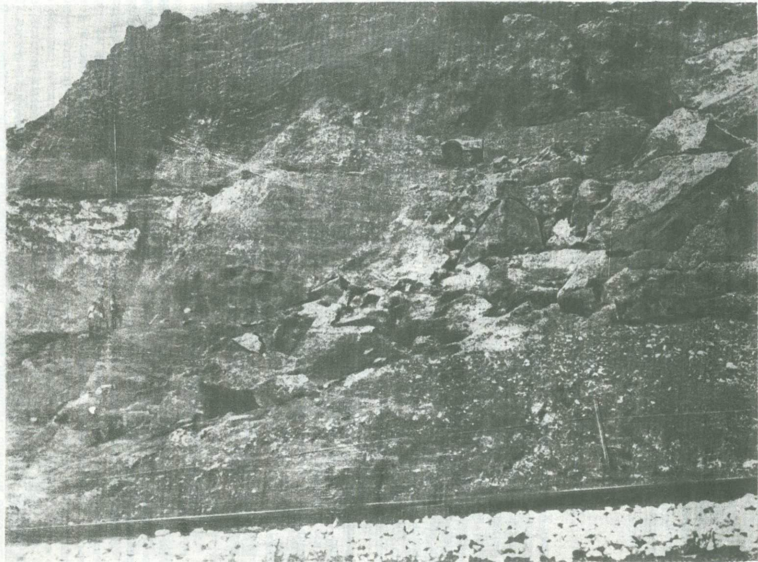
Рис. 3.11. Вид оползня, наползающего на железную дорогу
