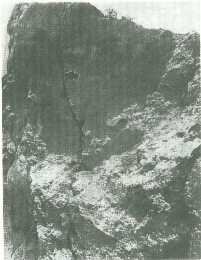
Рис. 3.9. Реликтовая трещина в массе латерита в теле оползня.
