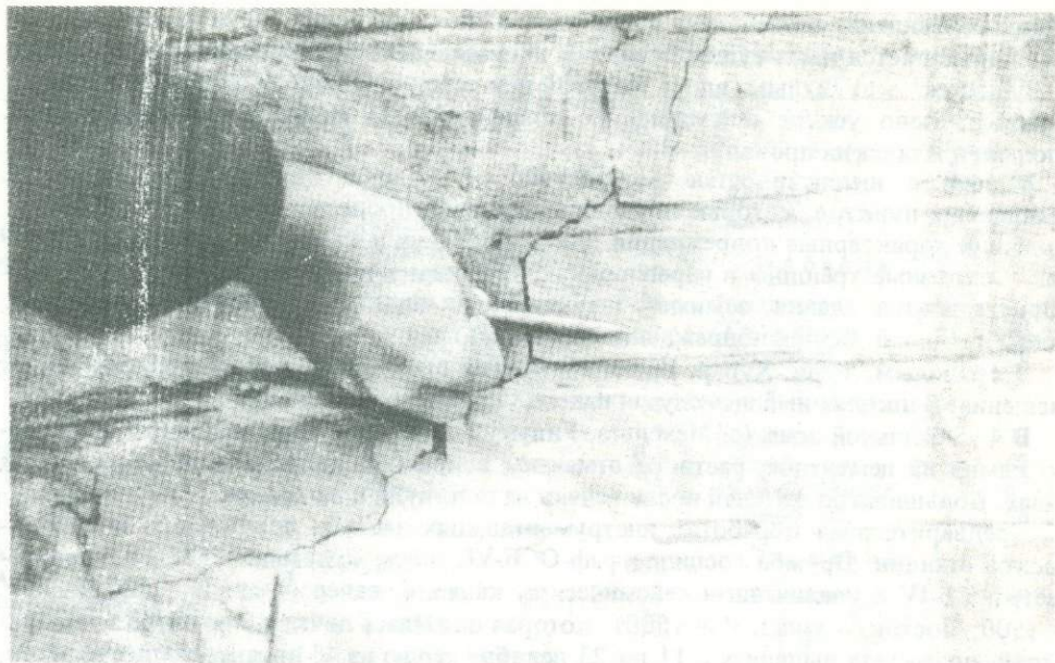
Рис. 4. Расслоение кладки в здании школы с. Инче
