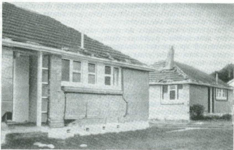
Рис. 103. Трещины в стенах дома в Инангахуа, свидетельствующие о том, что кирпичи не всегда прочнее связывающего их цемента
