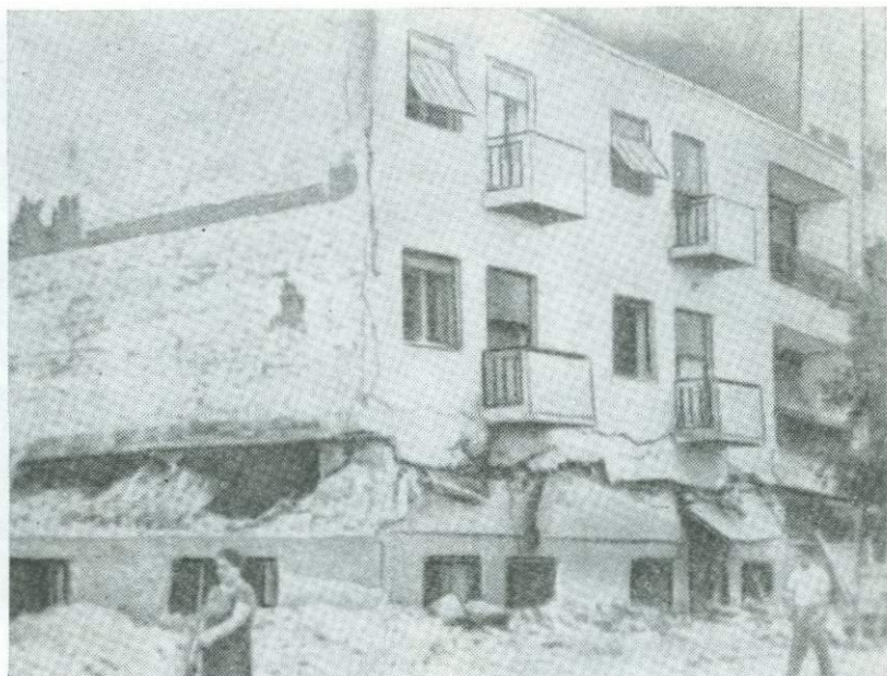
Рис. 109. Неармированная кирпичная кладка. Первый этаж этого кирпичного жилого дома в Скопье был разрушен землетрясением в то время, как верхние этажи остались почти неповрежденными
