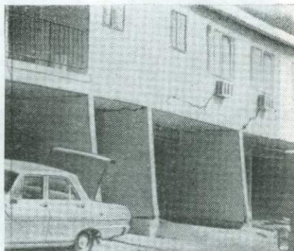
Рис. 114. Легкие, не связанные между собой стены жилого здания в Сан-Фернандо не выдержали боковых силовых воздействий, вызванных горизонтальным смещением опиравшихся на них масс
