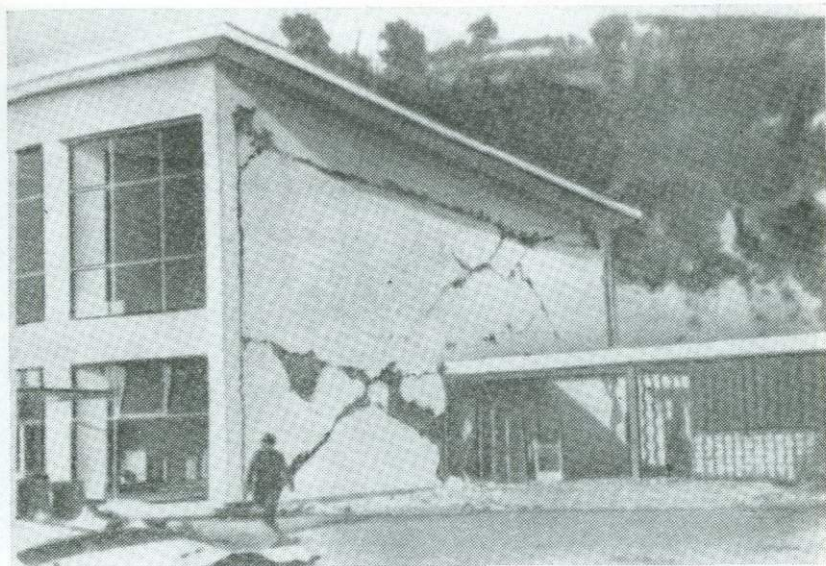
Рис. 108. Панельные каркасные дома. Железобетонный каркас этого выставочного здания в Скопле устоял при сотрясении, но на кирпичной кладке стен появились типичные X-образные трещины, свидетельствующие о возникновении напряжений сдвига
