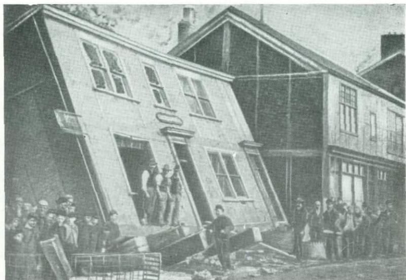
Проседание в Чeshire, обусловленное добычей соли. Подобные явления настолько распространены в этой местности, что здания снабжают деревянными стропилами, с помощью которых их иногда удается вернуть в первоначальное положение.
