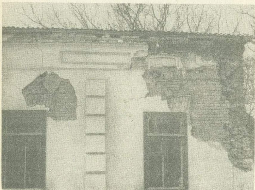
Рис. 6. Леово. Повреждения 4-й степени в здании типа А
