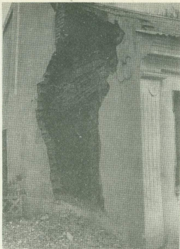
Рис. 7. Леово. Повреждения 4-й степени в здании типа А
