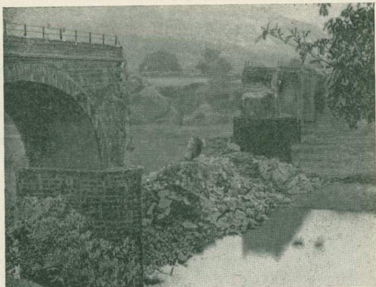
Р и с. 25. Разрушенный арочный мост ручной каменной кладки по дороге Хелвак—Чиплун.
