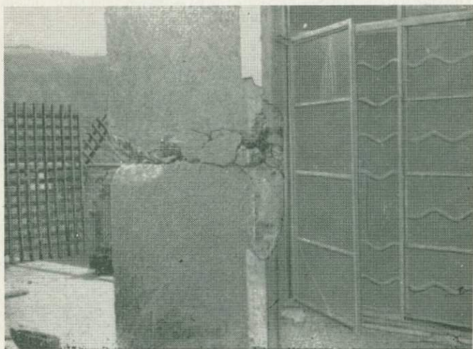
Р и с. 32. Горизонтальная трещина в бетонной стене пультовой на секции 24.
