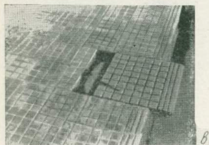
Р и с. 30. Смещение незакрепленных плит в одной из секций плотины Койна, увеличивающееся к центру пролета (от a к б ).
