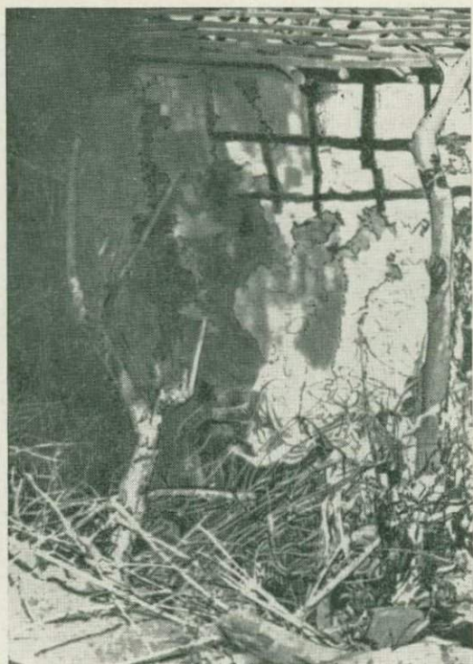
Рис. 24. Разрушение стен в домах 4-й категории, сложенных из камня на глинистом растворе.
