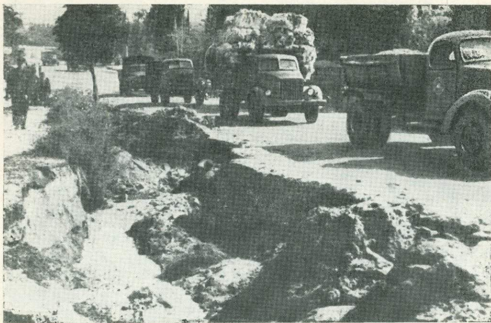
РИС. 23. Дорожная эрозия (размыв кювета)
