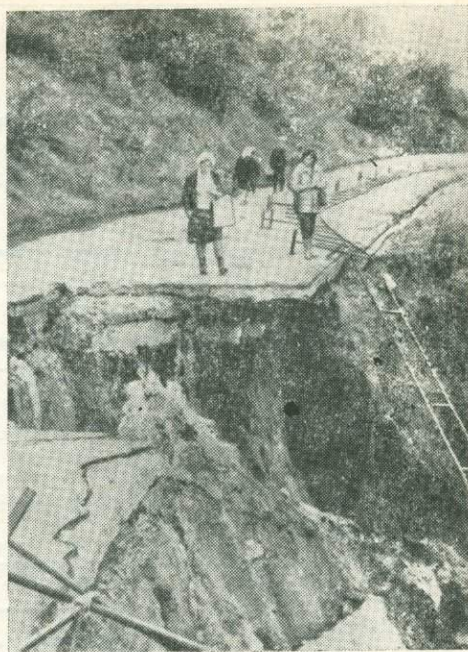
РИС. 16. Дорожный оползень антропогенного происхождения (фото О. Н. Ларичева)
