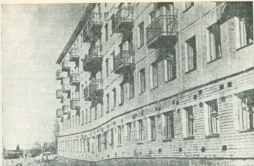
РИС. 39. Деформация жилого дома, вызванная протаиванием мерзлого грунта (фото А. И. Дементьева)
