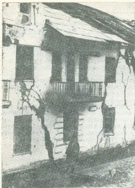
РИС. 45. Повреждение здания, вызванное неравномерным проседанием подработанной территории
