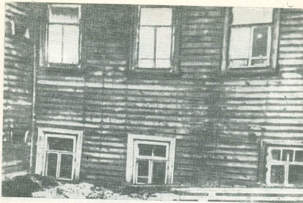
Рис. 44. Осевший дом, построенный на торфянистых грунтах
