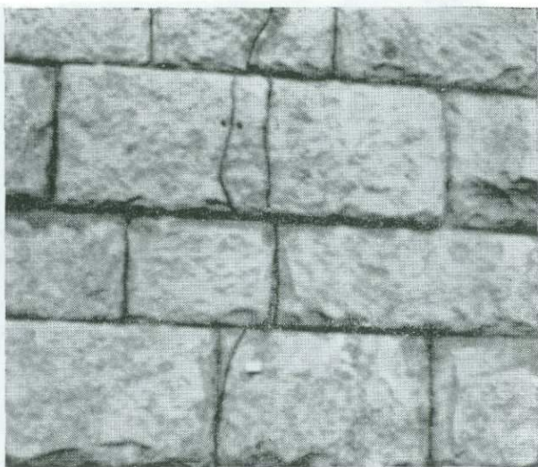
Фиг. 19. Трещины в облицовке одного из мостов в Москве. Пример неправильной установки камня в облицовке
