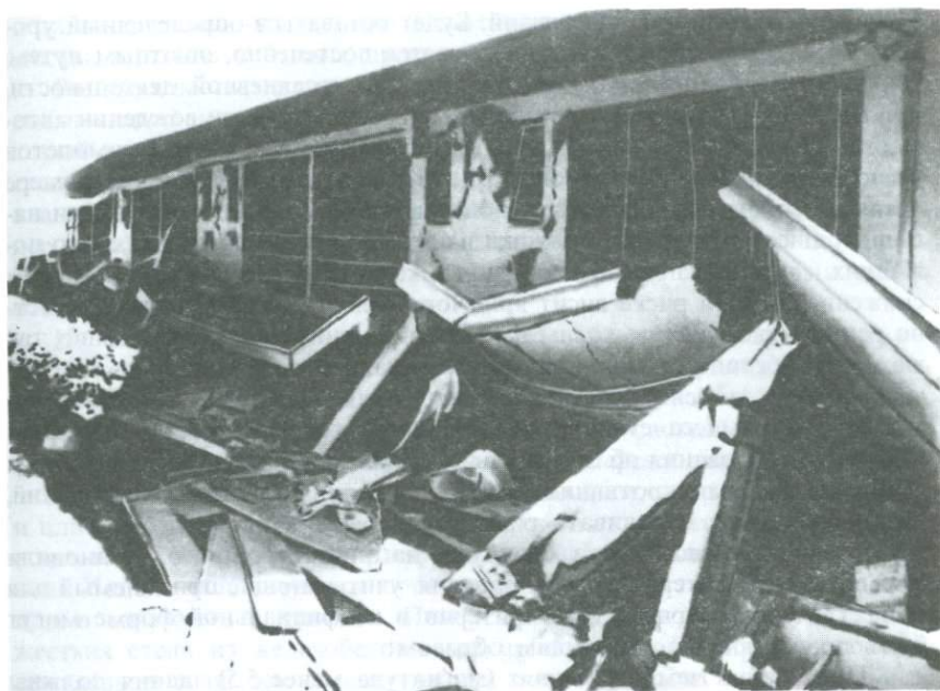
Первый этаж здания посольства США в Манагуа полностью обрушился при землетрясении 1972 г., раздавленный вторым этажом. Фото авторов.
