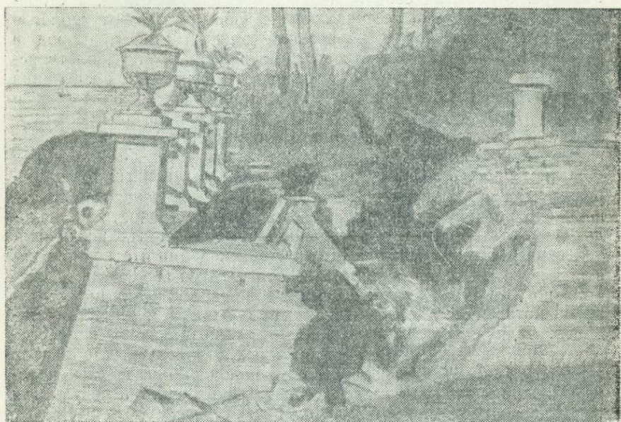
Рис. 1. Разрушение оползнем экспланады и лестницы Приморского парка в Сочи.
