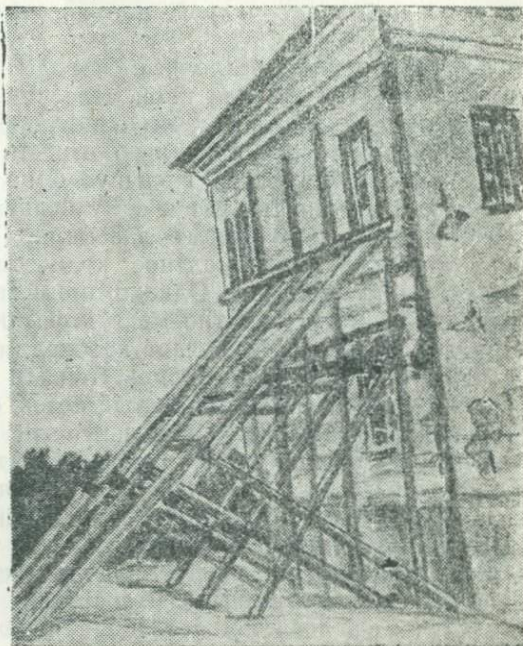
Рис. 39. Деформации здания школы в г. Туле в результате просадки грунта, вызванной замачиванием при тушении пожара.
