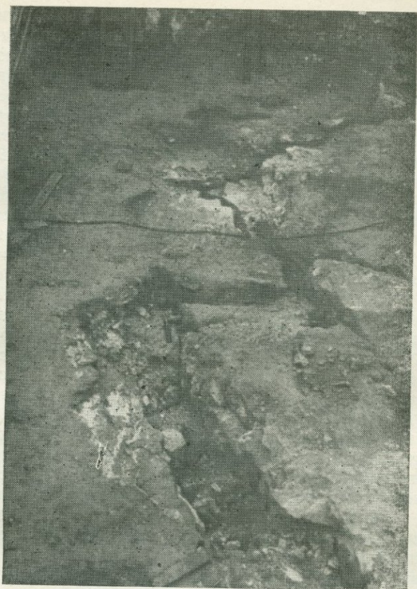
Рис. 5.37. Трещины в фундаменте цистерны, построенной на песчаниках мелового возраста вблизи Раеца (Моравия).
