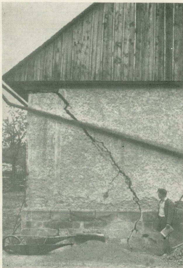
Рис. 5.36. Типичная трещина в здании с фундаментом мелкого заложения, вызванная высыханием мергеля мелового возраста (фото Зарубы).
