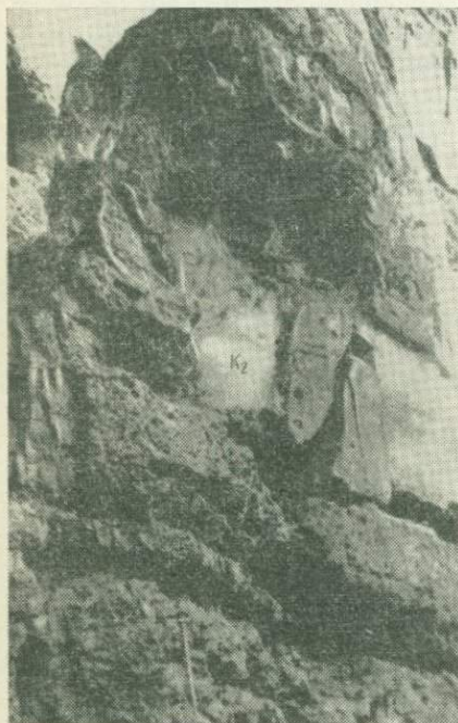
Рис. 37. Зона трещиноватости в известняках верхнего мела в районе балки Леночки
