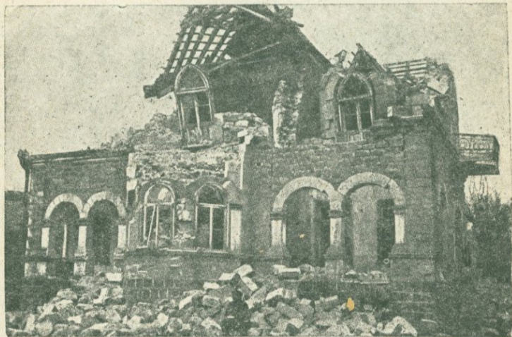
Рис. 183. Разрушения в г. Балаклаве во время землетрясений в 1927 г. (фот. П. А. Двойченко).
