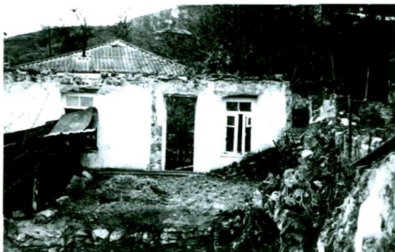
Рис. 82. Оползневые массы деформировали жилое здание по улице Арутюнян в г.Канан (фото Д.Г.Аракеяна)
