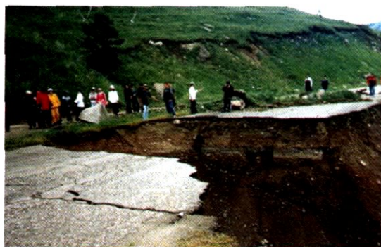
Рис.79. Разрушенное полотно автодороги выше с.Артаваз (фото В.Р.Бойнагряна)
