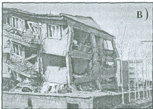
Рис. 3.4(2) Результат нарушения норм и правил сейсмостойкого строительства: а) в Армении (Спитакское землетрясение, 1988г., M=7.0 ): б) в Иране (Ардебильское землетрясение, 1976г., M=7.2 ): в) в Турции (Эрзинджанское землетрясение, 1992г., M=6.8 ).
